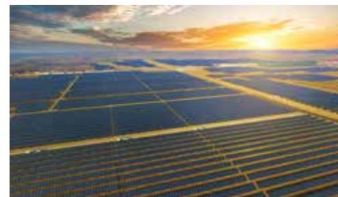
▶ 山东聊城冠县70MW农光互补扶贫电站
